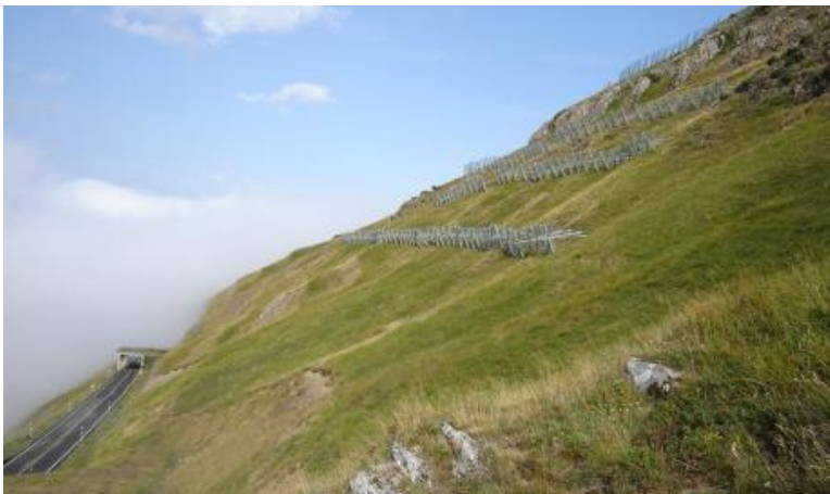
Figura 5. Barreras flexibles modulares instaladas para la protección de la carretera C142, de acceso a Beret (Valle de Arán).
