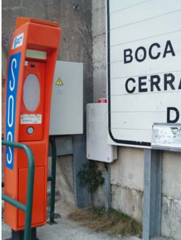
Puesto S.O.S. exterior
