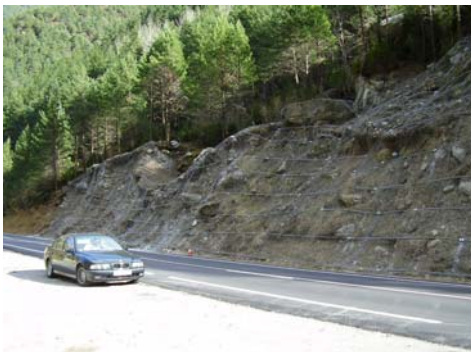
Mallas de contención
